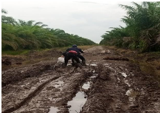
Gambar 5. Badan Jalan rusak
