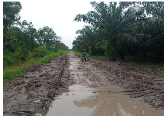
Gambar 6. Badan Jalan tergenang air
